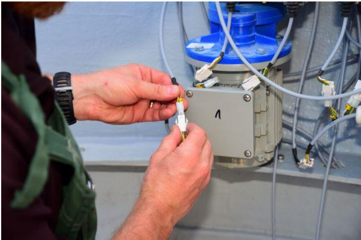
Rys. 33 – podłączenie przewodu zasilania silnika lewej strony podstawy kopuły do sterownika
