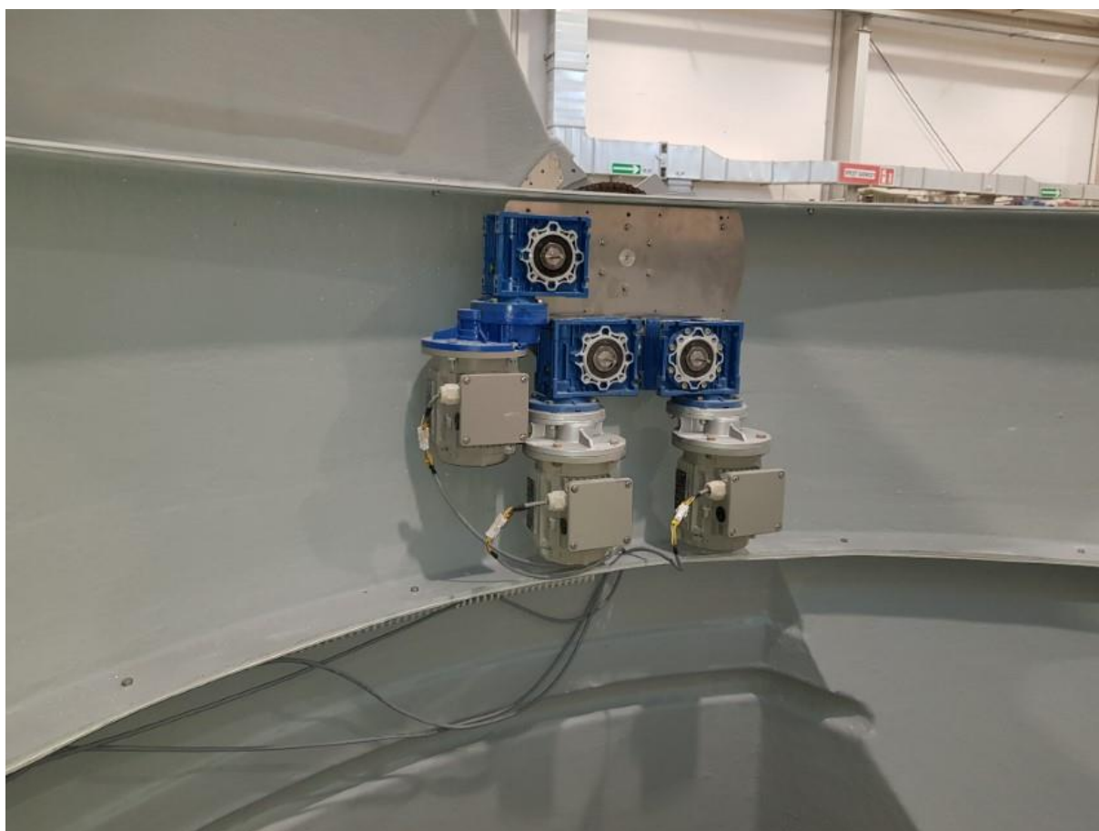
Rys. 32 – przewody połączeniowe zasilania silników lewej strony podstawy kopuły
