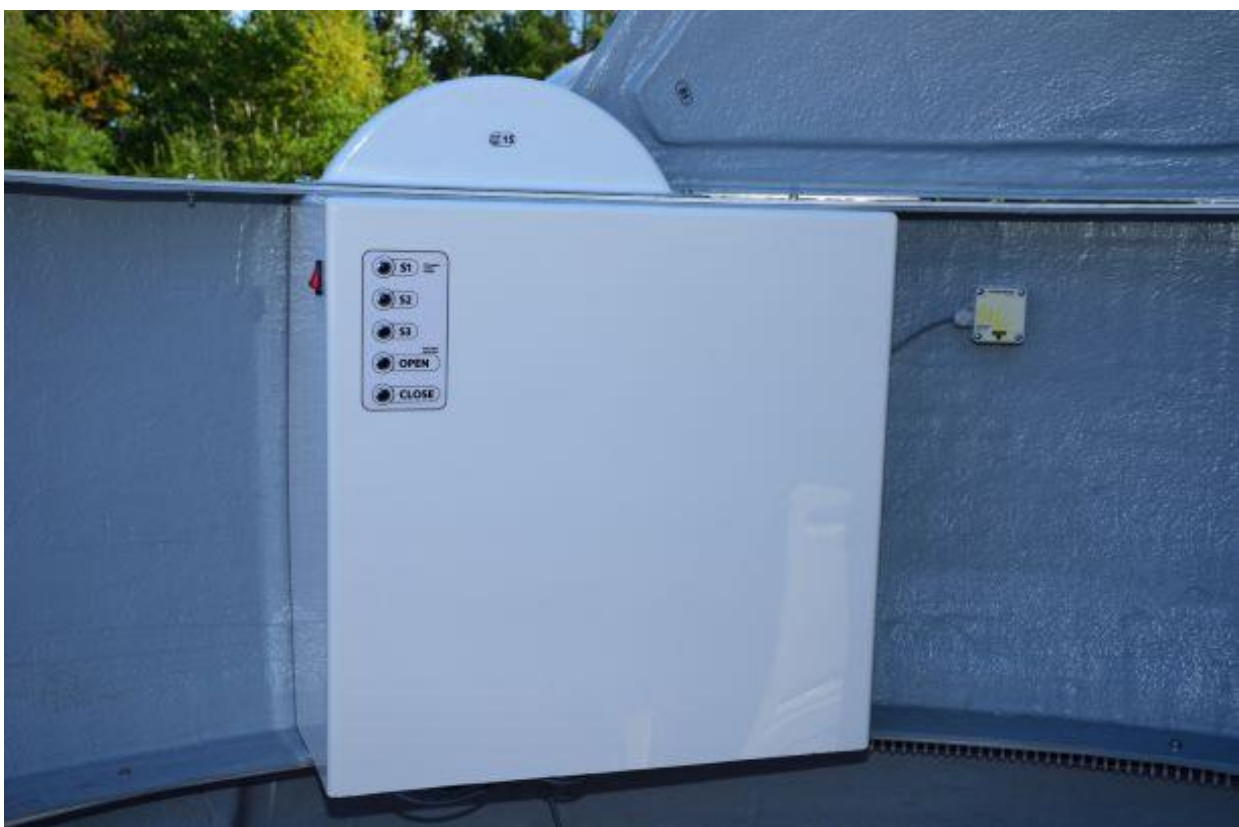
Rys. 34 – panel sterujący ręcznym otwieraniem kłap kopuły
