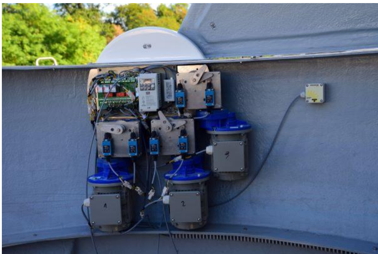
Rys. 35 – widok wyłączników krańcowych i elementów sterujących pracą kłap kopuły Instalacja pokrywy kopuły nr 1
